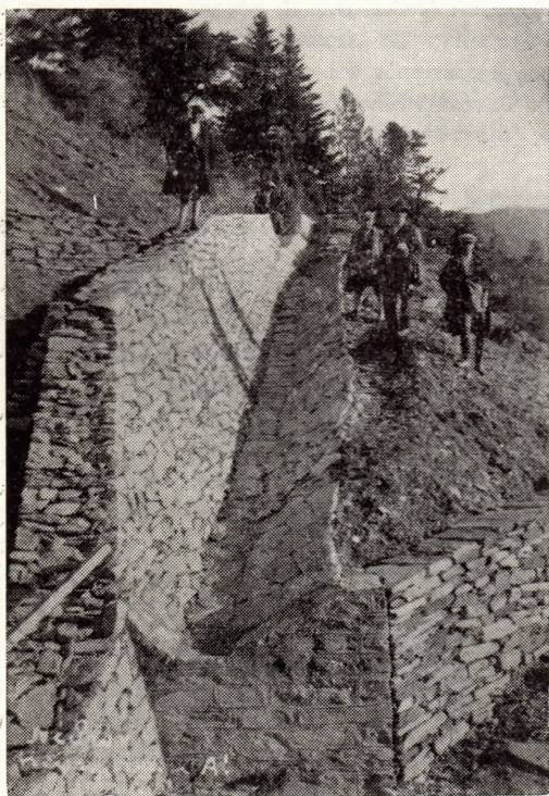
Τάφροι ἀποστραγγίσεως ὀλισθηγενοῦς ἐπιφανείας εἰς τὸ ἄνωτερον τμήμα τῆς λεκάνης τοῦ χείμαρρου. Κατάστασις 1934
